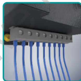
Подвод кабелей снизу
